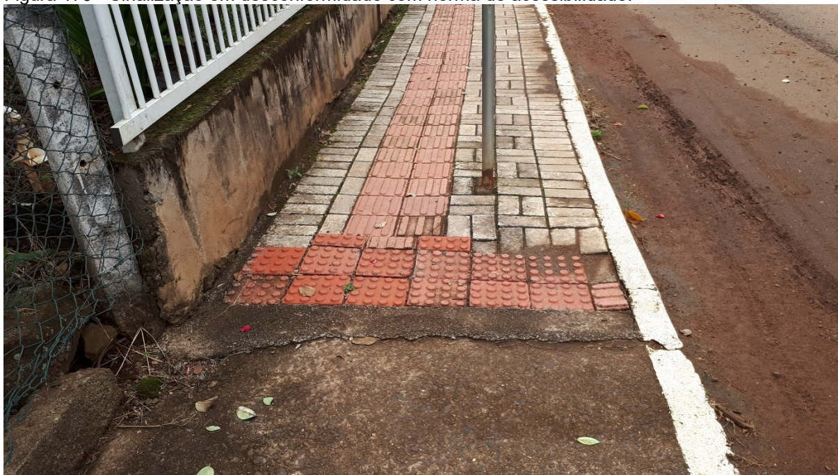
Figura 179 - Sinalização em desconformidade com norma de acessibilidade.
