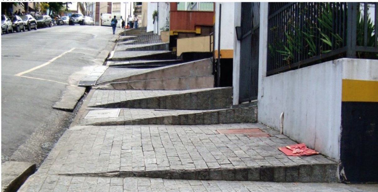
Figura 83 – Imagem da questão da utilização integral dos passeios para rampas de acessos de veículos.
