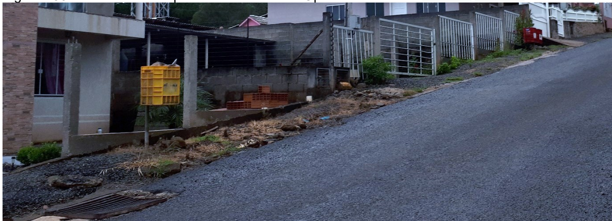
Figura 180 - Inexistência de passeios na Rua dos Operários.
