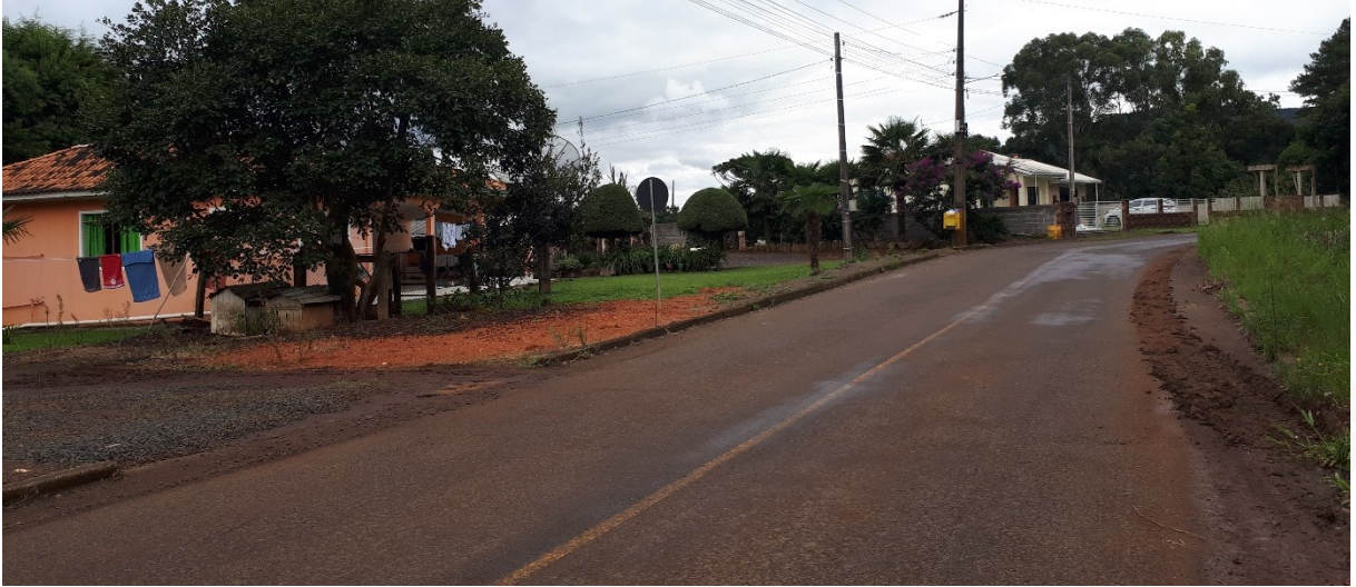
Figura 177 - Inexistência de pavimentação nos passeios da Avenida Vinte de Julho.
